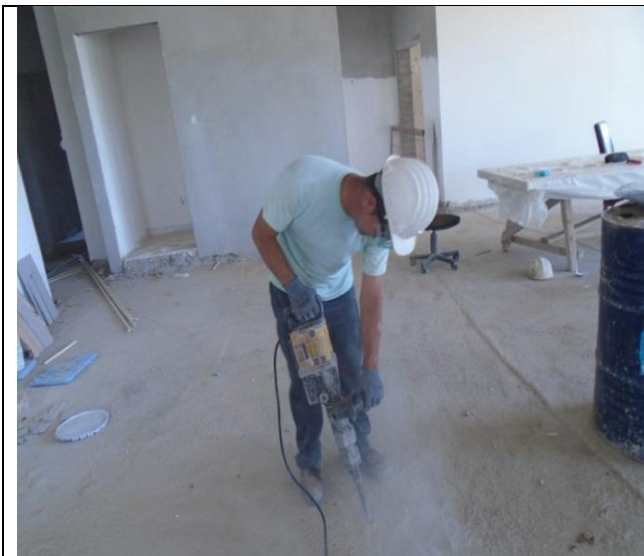
Practică defectuoasă - utilizarea unui concasor operat manual nedotat cu echipament de îndepărtare a prafului (DLI, Cipru)
