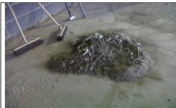
Practică defectuoasă - Îndepărtarea molozului prin măturarea uscată (HSE, Regatul Unit)
