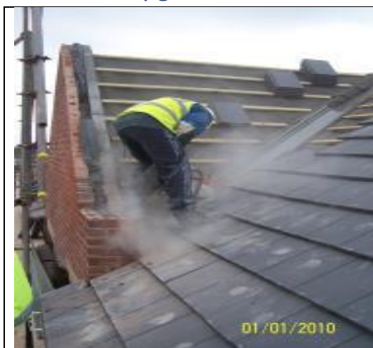
Practică defectuoasă - tăierea țiglelor fără măsuri de control (National Federation of Roofing Contractors Ltd, Regatul Unit)
