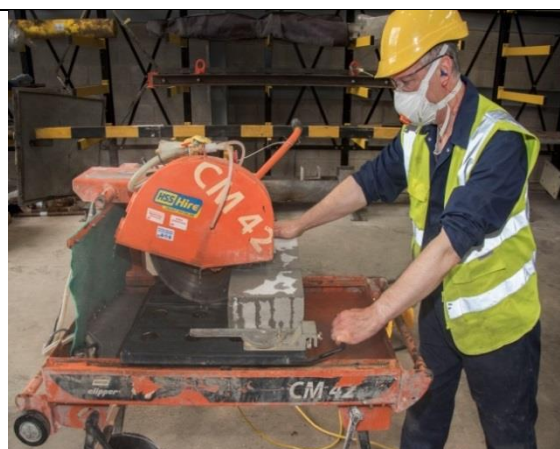
Bună practică - utilizarea suprimării cu apă (ilustrată) și EPR purtat de către operator (HSE, GB)
