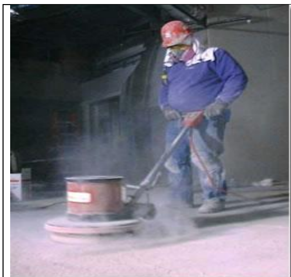
Practică defectuoasă - șlefuirea pardoselilor de beton utilizând unelte nedotate cu echipamente de îndepărtare a prafului (GDWW, Belgia)
